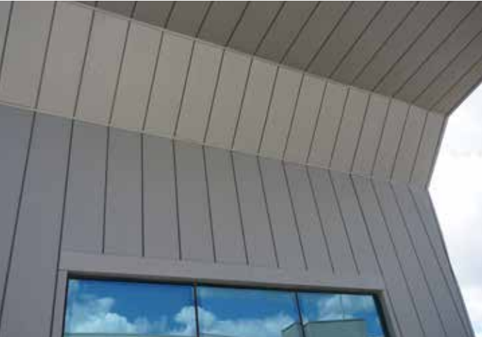
VMZ Interlocking Sistem – Dilovası Miosb Giriş Kapısı, Gebze
